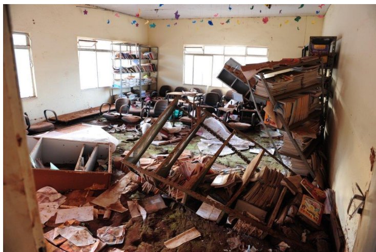
Figura 1 – Biblioteca da Escola Municipal de Paracatu de Baixo (MG), uma das cidades atingidas pelo desastre causado pela Mineradora Samarco. Esta escola, localizada no centro de Paracatu, ficou completamente destruída, pois a lama atingiu até o segundo andar do prédio. Segundo relatos de moradores, na hora em que a lama chegou, os moradores já haviam abandonado a cidade. Reportagem feita para a Fiocruz.
